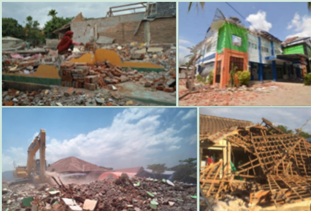
Gambar 5 Kerusakan Fasilitas Kesehatan, Pendidikan dan Perumahan
