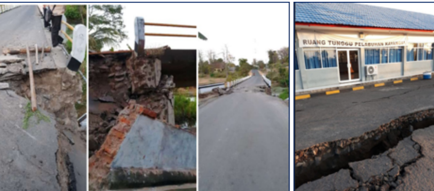
Gambar 6. Kerusakan Jalan dan Jembatan
